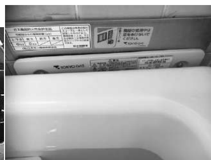
ガス式風呂釜の浴室内表示
